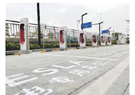
园区新能源汽车充电设备
